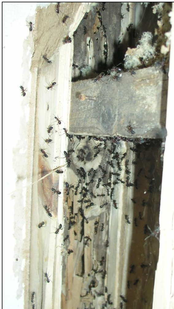
Figur 2. Reir etablert i overgang mellom isolasjon og reisverk i vegg.
